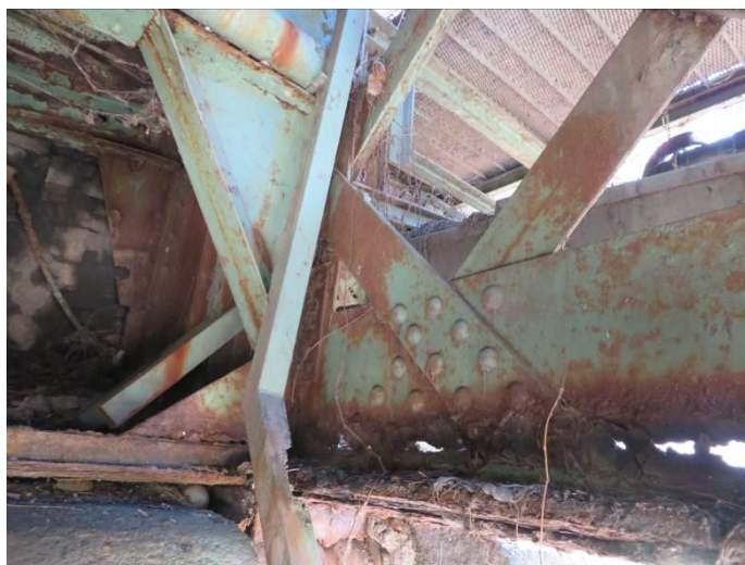
Figura 6-34: Immagine esemplificativa dello stato di conservazione in corrispondenza degli appoggi
