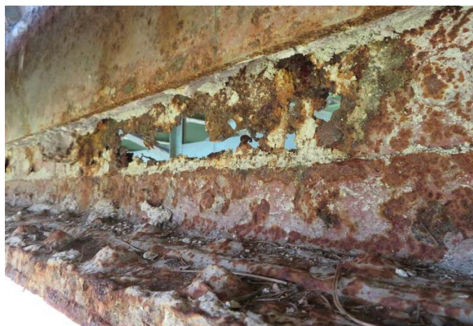
Figura 6-27: Immagine dello stato dei correnti inferiori – corrosione avanzata con fori in corrispondenza dell'anima
