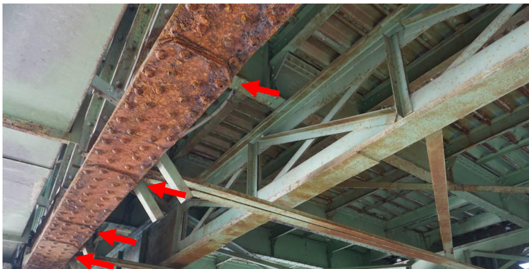
Figura 5-9: Fotografia - Dettaglio del corrente inferiore della reticolare. Nell'immagine viene indicata, con una freccia rossa, la sovrapposizione dei piatti che costituiscono la piattabanda del profilo
