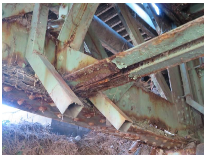
Figura 6-33: Immagine esemplificativa dello stato di conservazione degli elementi trasversali
