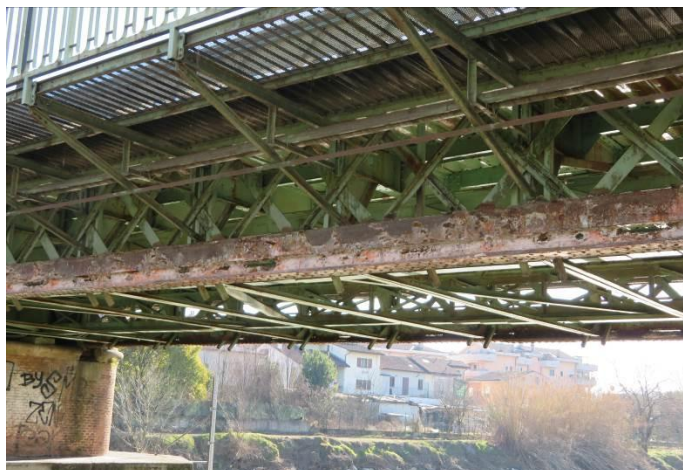
Figura 6-26: Immagine dello stato dei correnti inferiori – corrosione avanzata con fori in corrispondenza dell'anima
