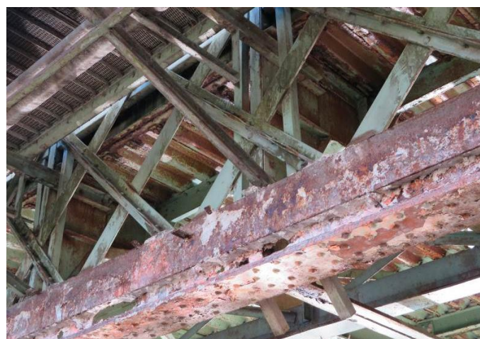
Figura 6-28: Immagine dello stato dei correnti inferiori – corrosione avanzata con fori in corrispondenza dell'anima
