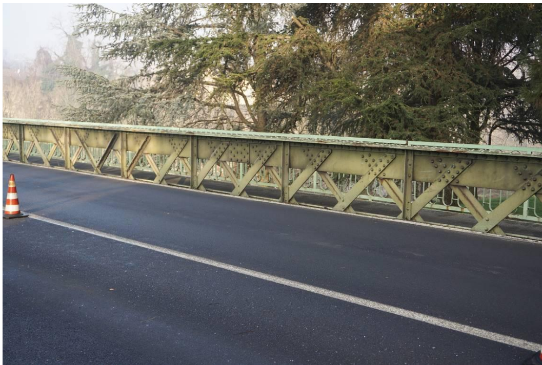
Figura 5-5: Fotografia – Dettaglio del corrente superiore trave reticolare
