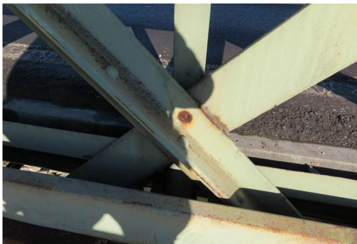
Figura 6-24: Mancanza degli elementi di collegamento
