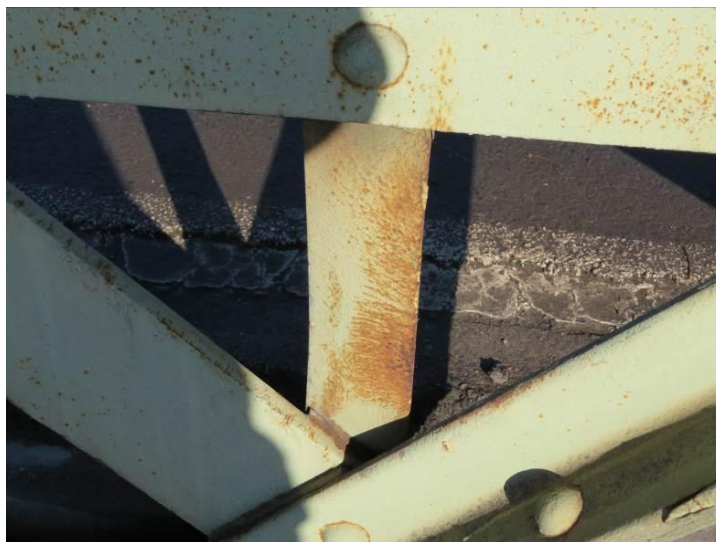
Figura 6-19: Immagine esemplificativa dello stato di conservazione delle travi reticolari
