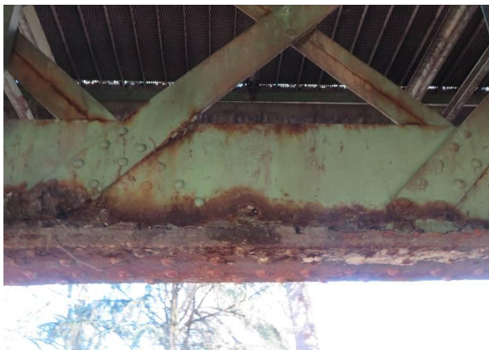
Figura 6-23: Immagine esemplificativa dello stato di conservazione delle travi reticolari – corrosione avanzata.
