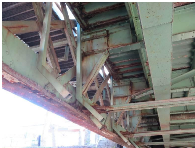
Figura 6-32: Immagine esemplificativa dello stato di conservazione degli elementi trasversali
