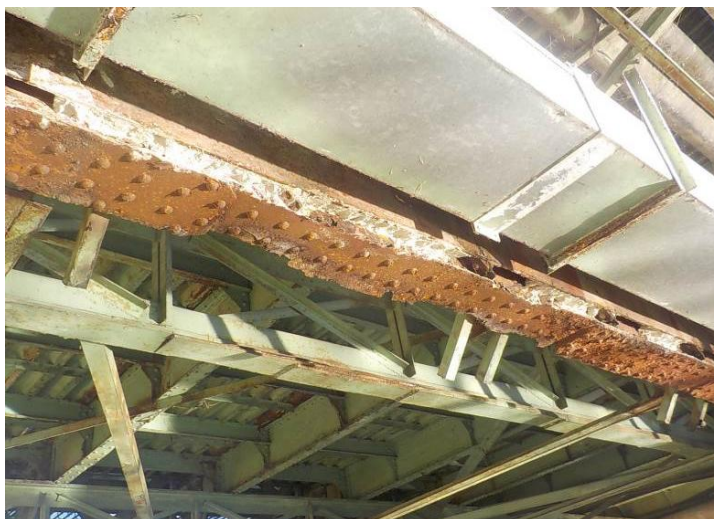
Figura 6-30: Immagine dello stato dei correnti inferiori – corrosione avanzata con fori in corrispondenza della piattabanda
