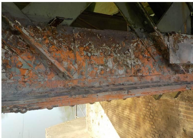
Figura 6-31: Immagine esemplificativa dello stato di conservazione delle travi reticolari – corrosione avanzata
