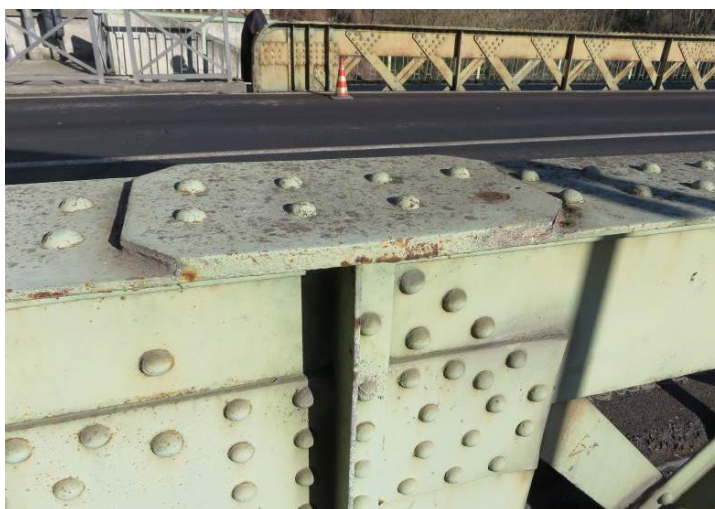
Figura 6-25: Mancanza degli elementi di collegamento
