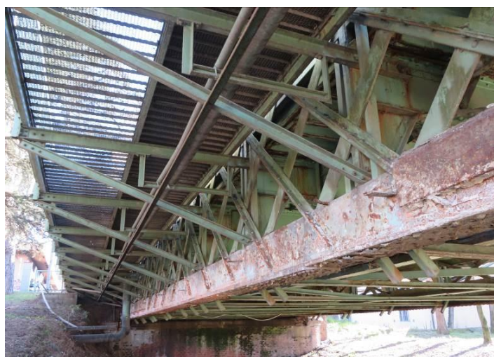
Figura 6-22: Immagine esemplificativa dello stato di conservazione delle travi reticolari – corrosione avanzata.
