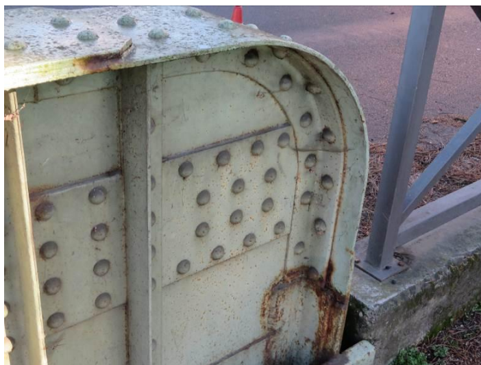
Figura 6-21: Immagine esemplificativa dello stato di conservazione delle travi reticolari
