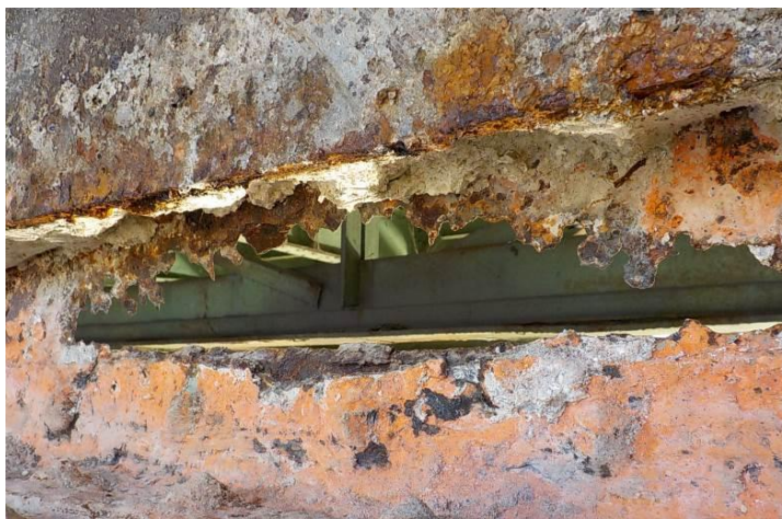
Figura 6-29: Immagine dello stato dei correnti inferiori – corrosione avanzata con fori in corrispondenza dell'anima
