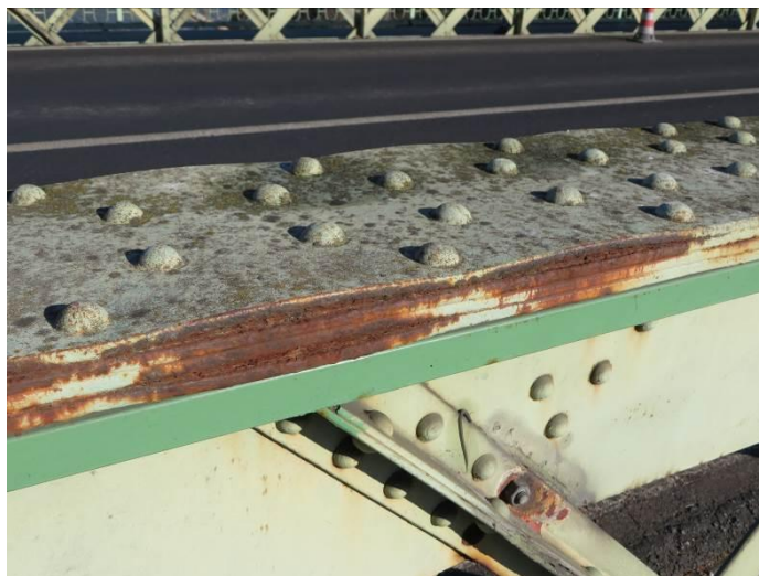
Figura 6-20: Immagine esemplificativa dello stato di conservazione delle travi reticolari
